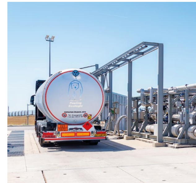
Baies de chargement de camions-citernes sur le site de Fos Cavaou
