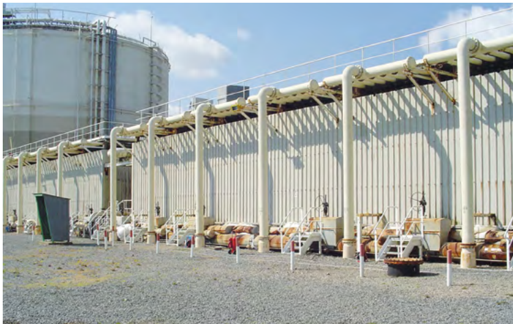
Regazéificateurs à ruissellement du site de Montoir-de-Bretagne
